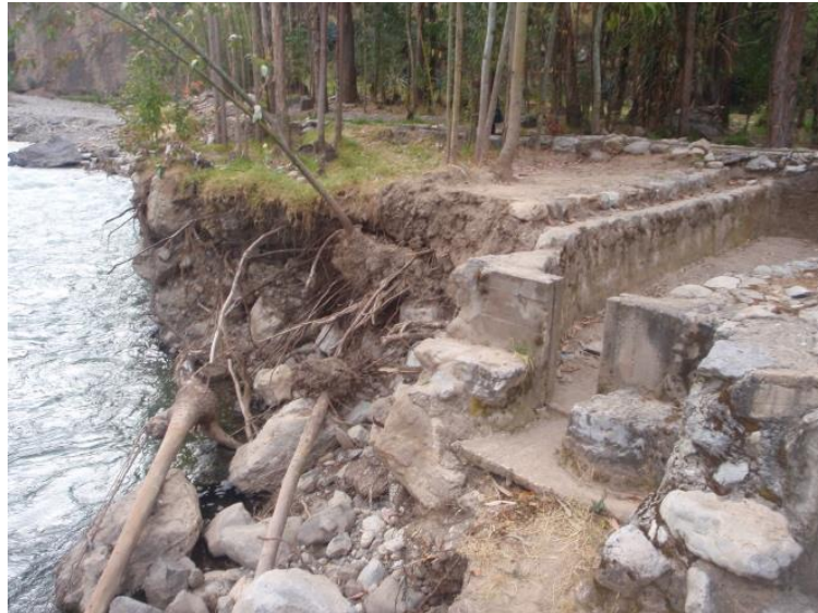
Foto 1. Estanques destruidos por creciento de río
